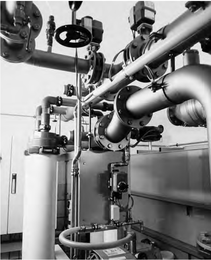
Moderne Filteranlage seit wenigen Tagen in Betrieb
